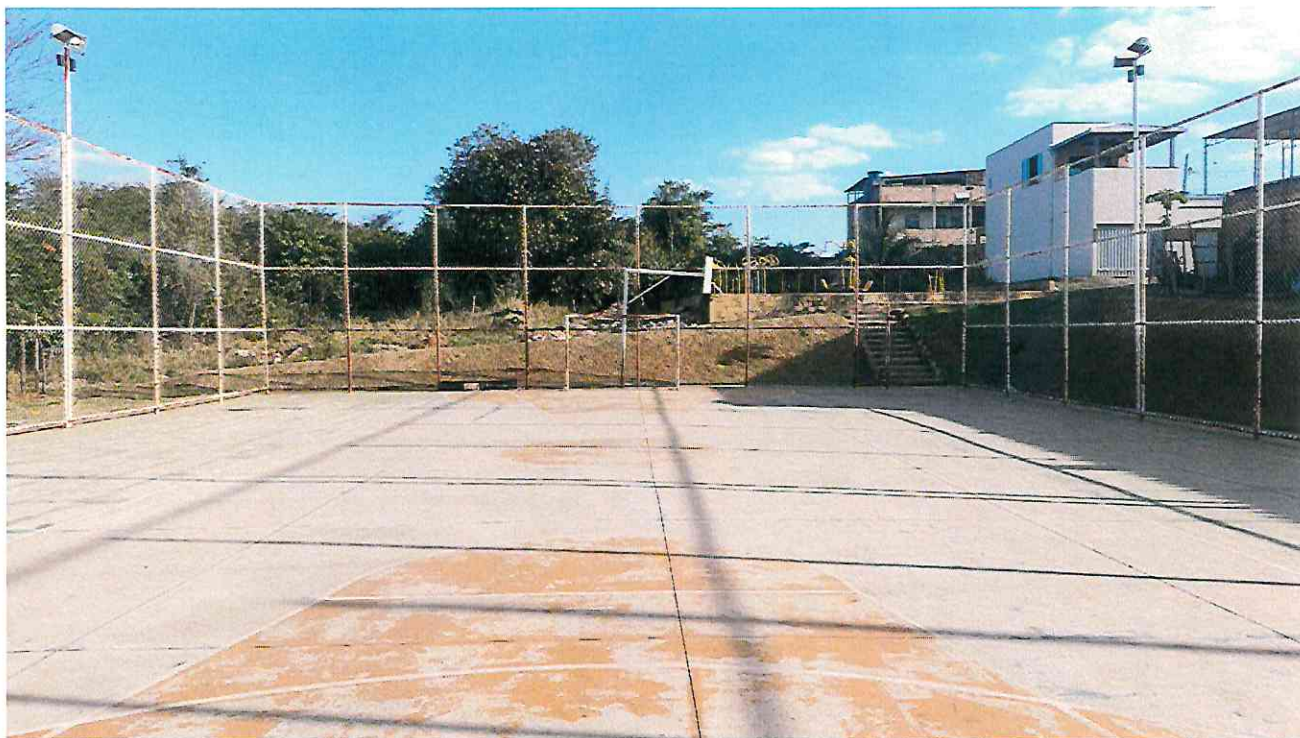
Foto 5 – Visão geral da parte interna da quadra, onde percebe-se a necessidade de pintura
