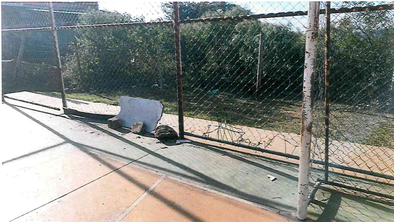
Foto 4 – Detalhamento do alambrado danificado e da necessidade de revitalização deste
